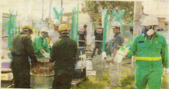
ANGGOTA bomba melakukan pembersihan dan membaiki sistem saluran paip gas yang bocor di Bukit Kemuning, Shah Alam semalam.
