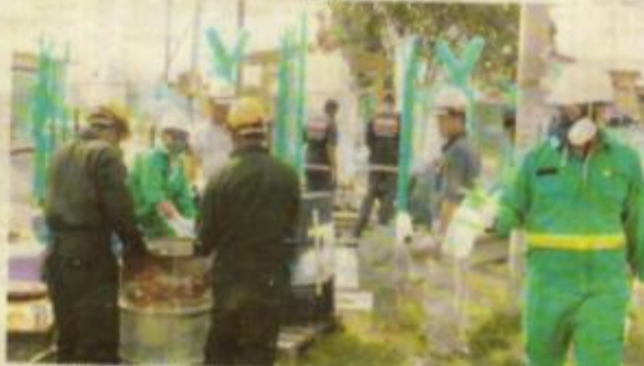
ANGGOTA bomba melakukan pembersihan dan membaiki sistem saluran paip gas yang bocor di Bukit Kemuning, Shah Alam semalam.
