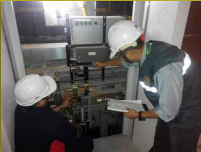
Pegawai membuat pemeriksaan ulangan ke atas salah satu komponen keselamatan pada pintu lif penumpang Officer inspecting one of the safety component at lift's car door during renewal inspection
